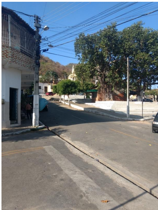
Figura 13: Foto da Praça da Capela de São Miguel, com meio-fio, arborizada e asfaltada, mas com passagem de esgoto a céu aberto, no encontro da Rua Santa Rita com a Rua Alto de Santa Rita.
