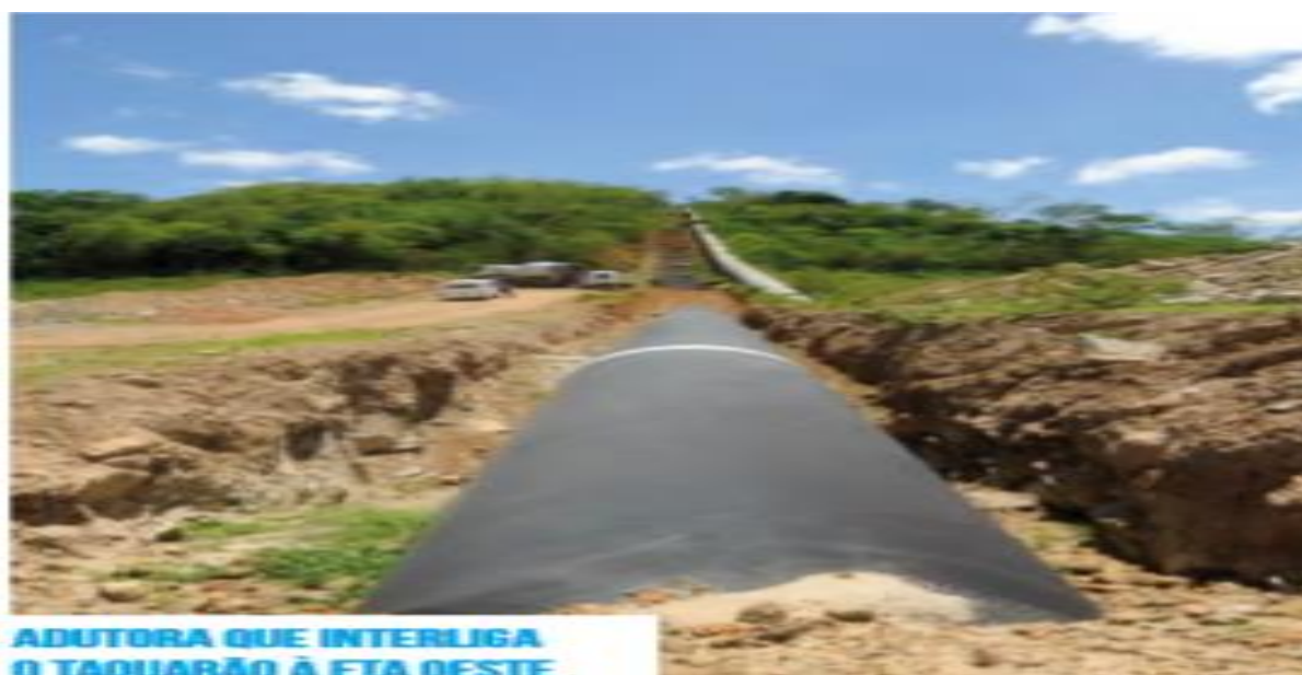
Figura 8- Adutora que interliga o reservatório de água do Taquarão a ETA Oeste.
