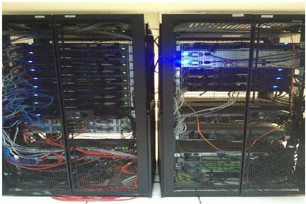
Foto 3 - Vista traseira do datacenter
