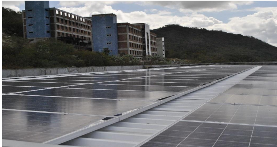
Foto 2 - Painéis fotovoltaicos de captação de energia solar
