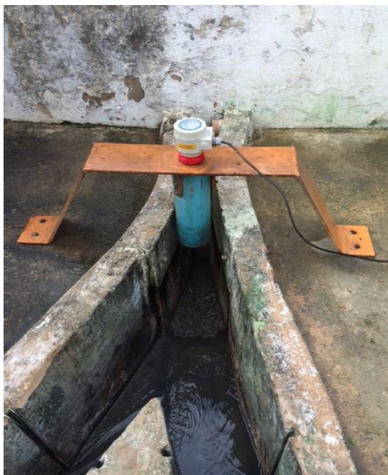
Figura 5 - Medidor de nível instalado.
