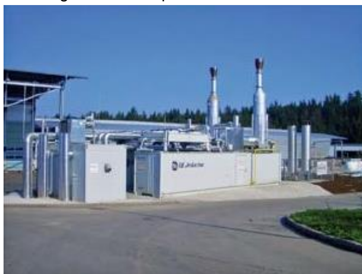
Figura 3 - Exemplo de uma usina CHP.
