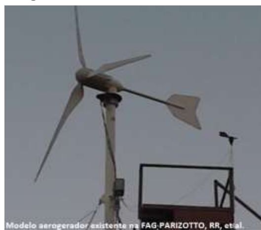
Figura 10: Sistema eólico de geração de energia da FAG
