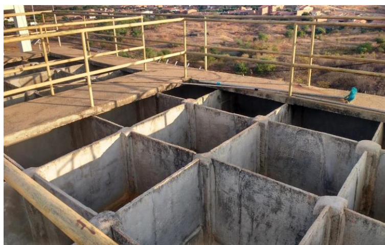
Figura 6 – Tanque de floculação
