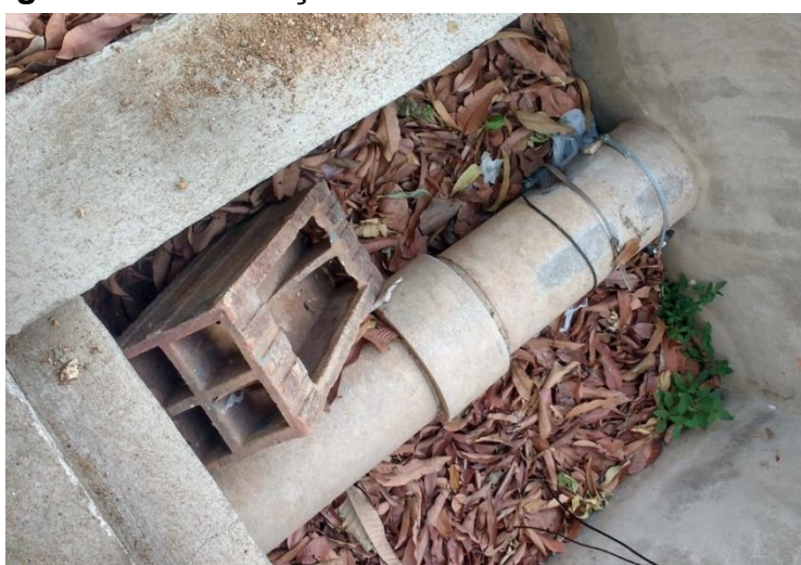
Figura 13 – Tubulação de amianto localizada na ETA
