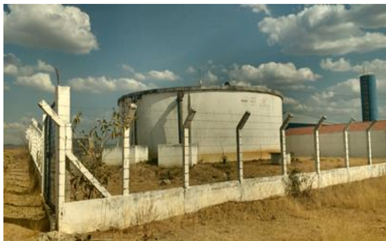
Figura 16 – Reservatório localizado no bairro Expedito Diógenes
