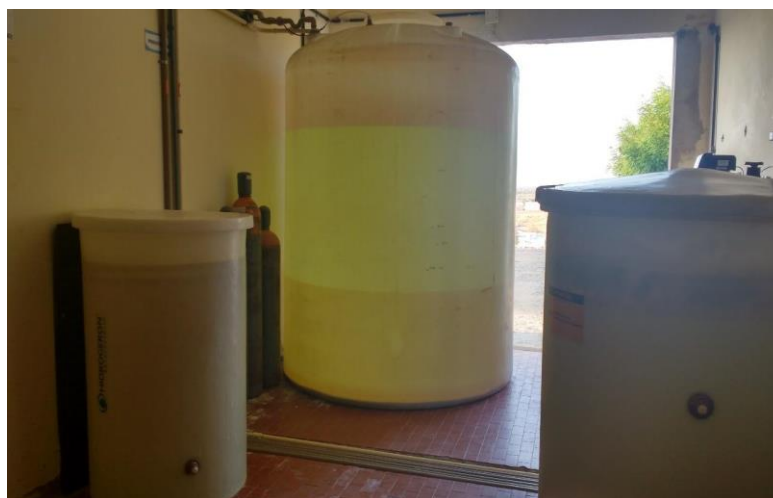
Figura 10 – Armazenamento do hipoclorito de sódio produzido
