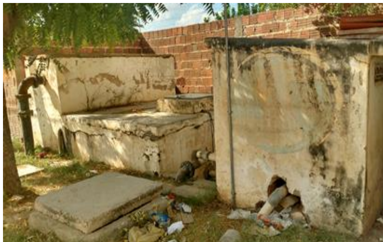
Figura 15 – Booster e cisterna localizados no setor 08
