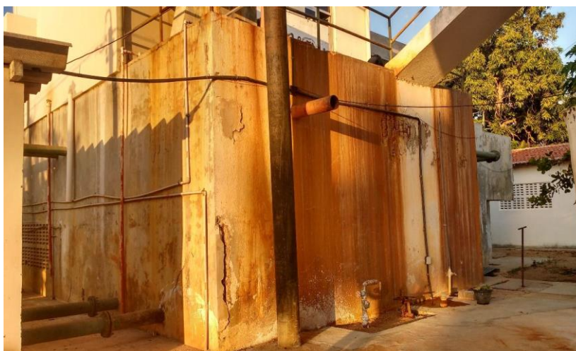
Figura 12 – Cisterna presente na ETA
