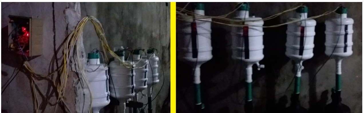
Fotografia dos Biodigestores em Operação
