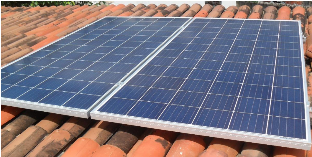
Figura 16 - Sistema solar fotovoltaico instalado em Serrota
