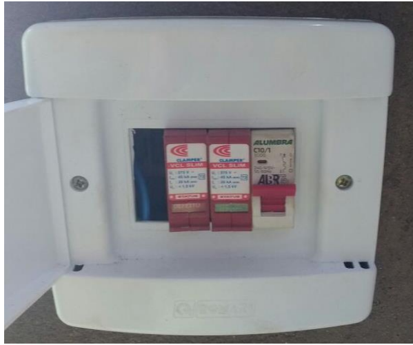
Figura 22 - Caixa de proteção CA.
