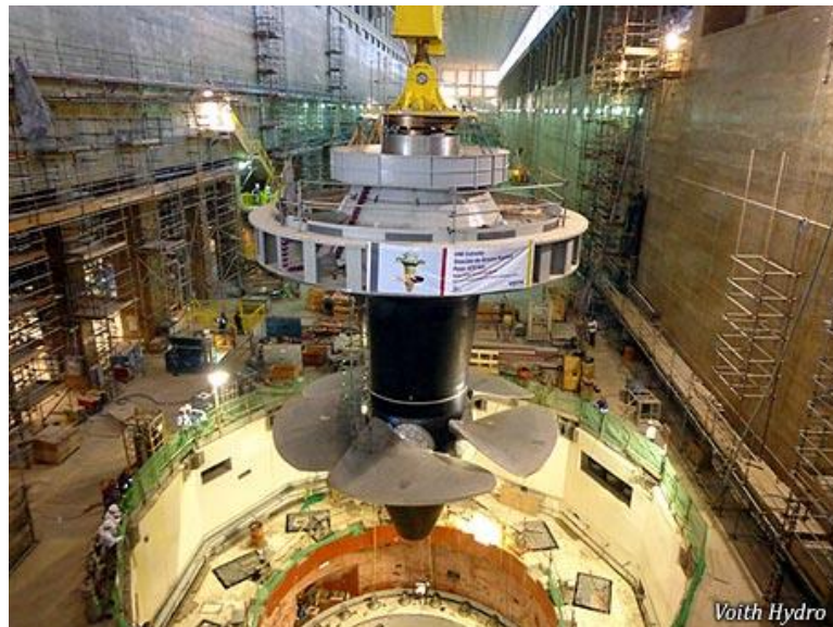
Figura 8 - Rotor Kaplan da Usina Hidroelétrica Estreito.
