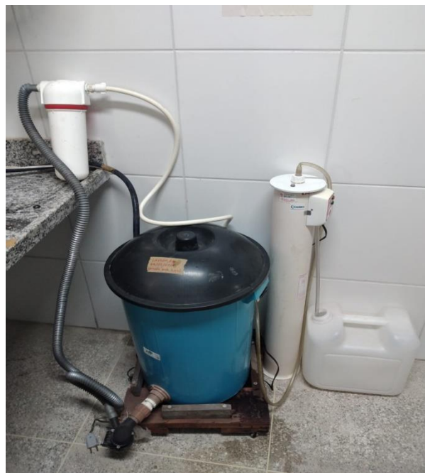
Figura 1 – Sistema de tratamento de água oriundo de ar-condicionado.
