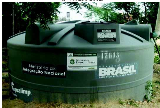
Figura 24 Cisterna de Polietileno da Comunidade de Carnaubinha dos Bezerras, a 1,6km da sede de Itapiúna, referente ao convênio nº 769231/2012.
