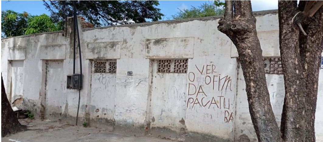
Figura 10 – Imagem de texto sobre parede em demolição no prédio da antiga Piladeira de Arroz na Rua Caio Prado Nº 633 – Centro, Pacatuba-Ceará. Fotografia, 28 de Julho de 2021
