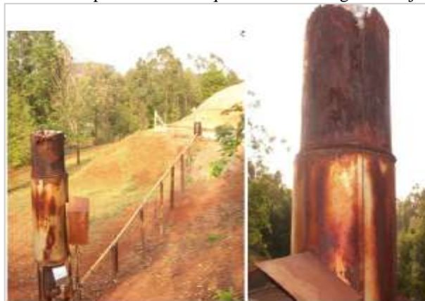
Figura 2 - Corrosão por H 2 S de um queimador de biogás de dejetos suínos
