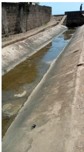
Figura 8 - Esgoto Sendo Lançado no Mar
