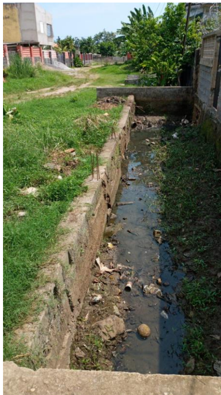
Figura 12 - Lançamento de Águas Residuais e Resíduos sólidos no corpo hidrico em Santo António
