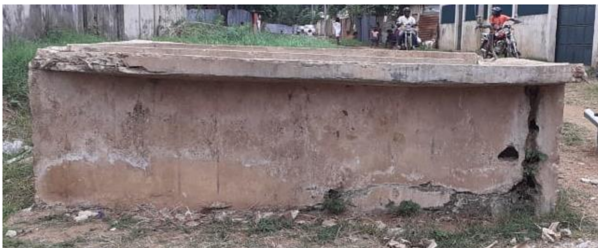
Figura 15- Lavandaria pública em fase de degradação em Santo António
