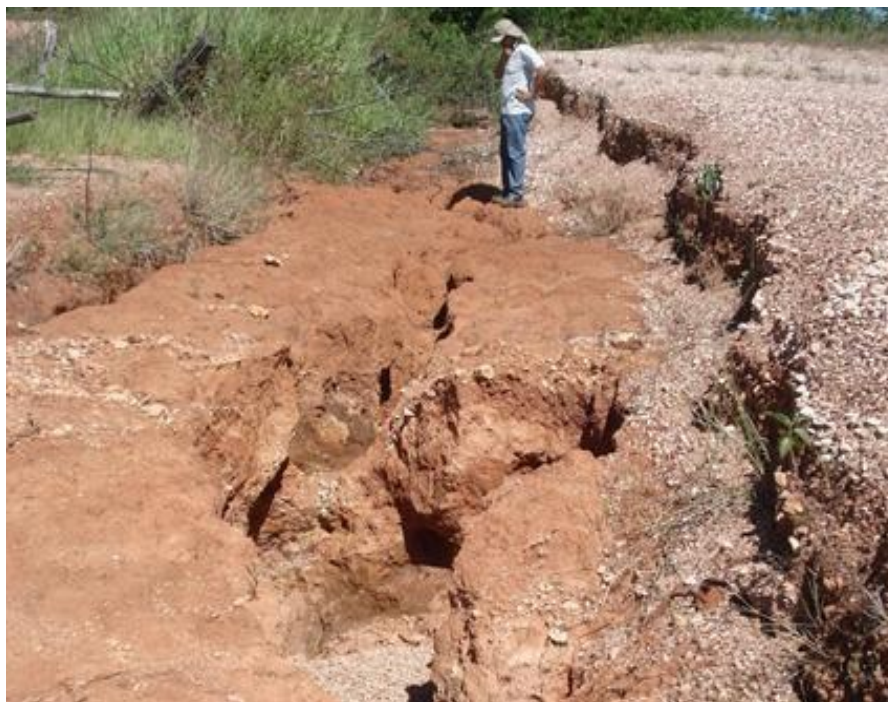
Figura 6: Erosão localizada na borda UHE Furnas Fonte: (SALES et al., 2017)
