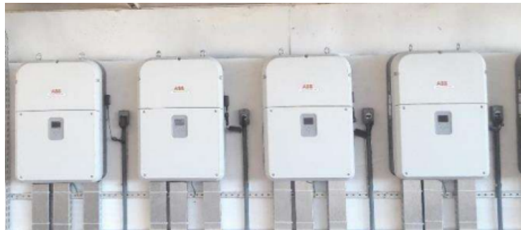
Figura 9 – Inversores fotovoltaicos trifásicos.
