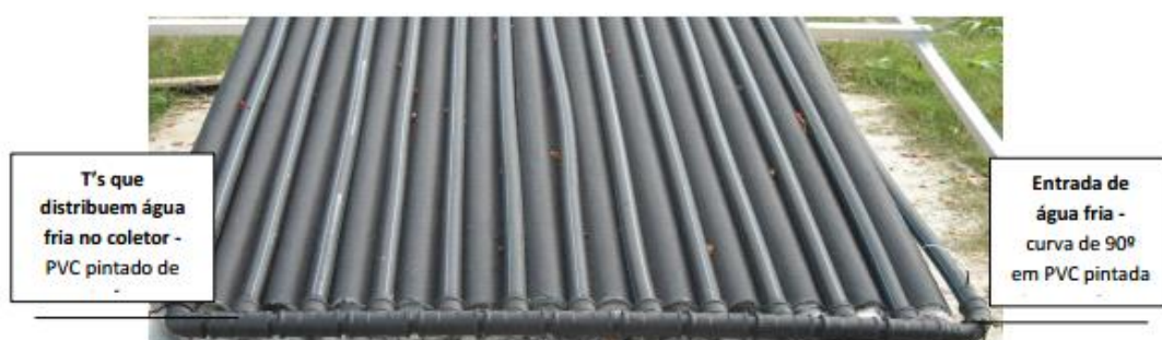
Figura 3 - Detalhe das conexões dos tubos de PEAD com os tês de PVC pintados de preto, (configuração III).
