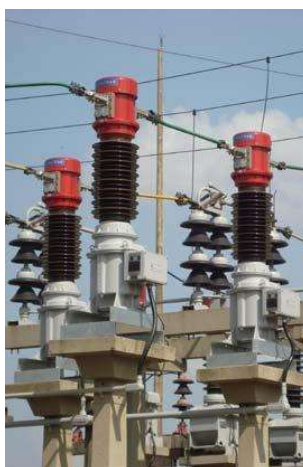
Figura 13 - TC de alta tensão - óleo
