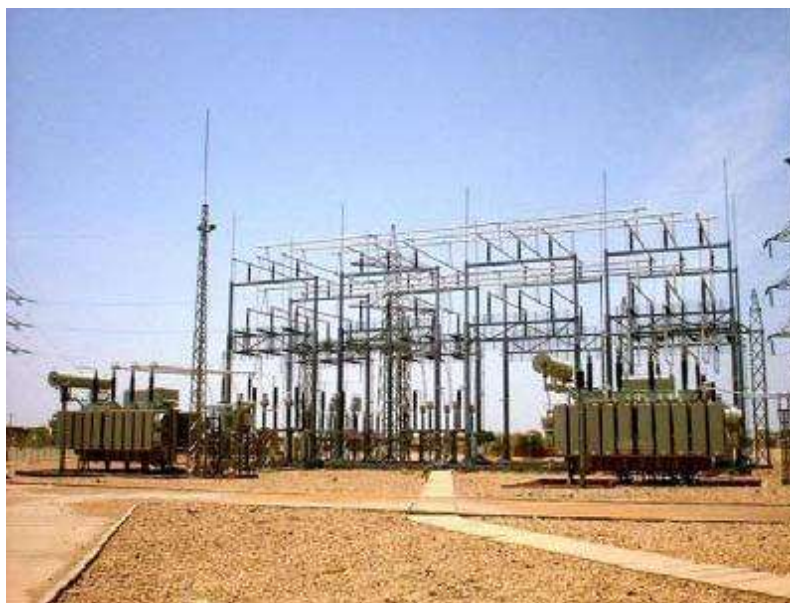
Figura 3- Subestação ao céu aberto
