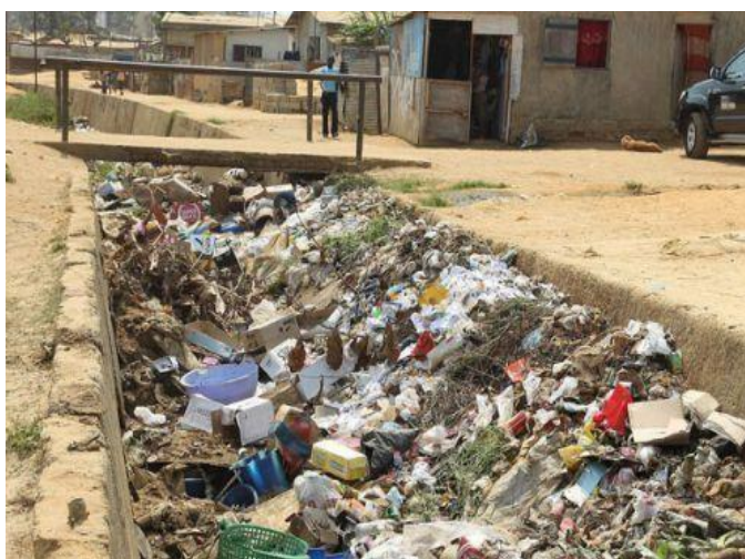
Figura 15-Vala de drenagem transformada em depósito de lixo.
