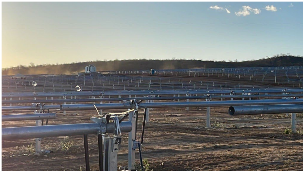
Figura 3 - Trackers instalados em uma usina.
