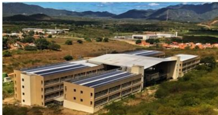
Figura 12 – Usina de minigeração fotovoltaica do Campus das Auroras
