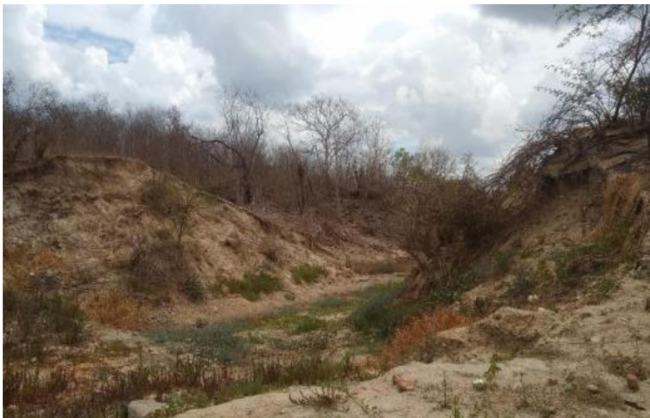
Figura 5 – Imagem da fenda após o rompimento
