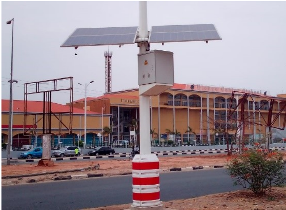
Figura 4 – Painéis Solares do município de Kilamba Kiaxi.
