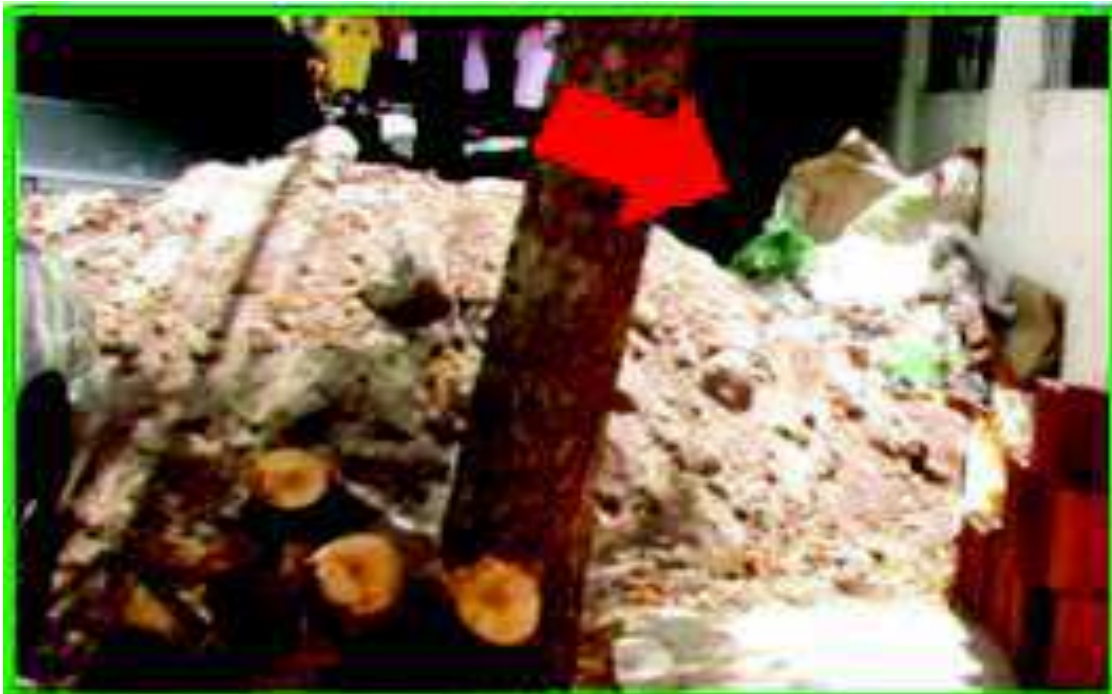
Figura 4 – Resíduos misturados aos materiais de construção.
