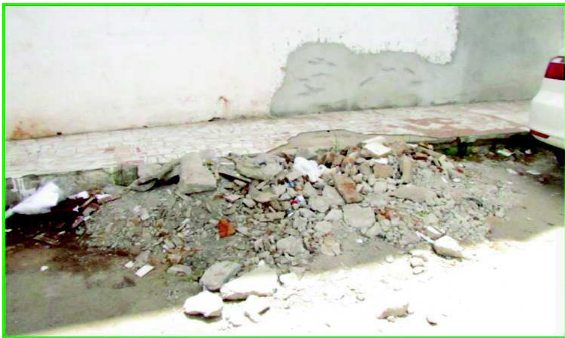
Figura 5 – Acesso obstruído com RCC.
