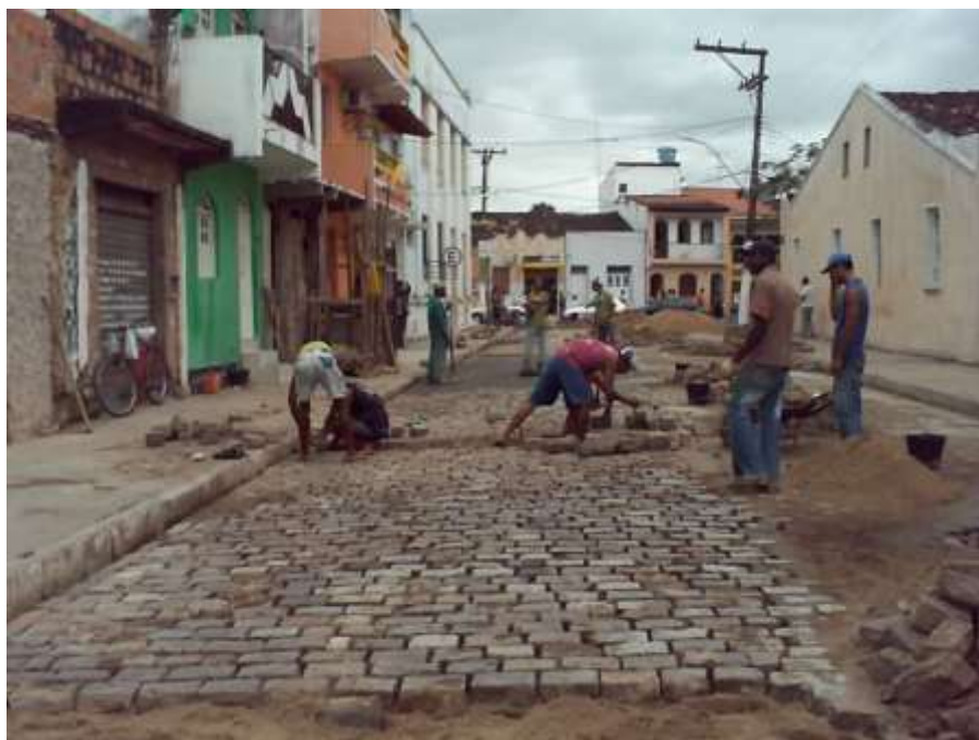
Figura 3 – Uso indevido da escória na pavimentação: a escória foi utilizada para o calçamento da cidade, construção de muros e jardins nas residências de Santo Amaro
