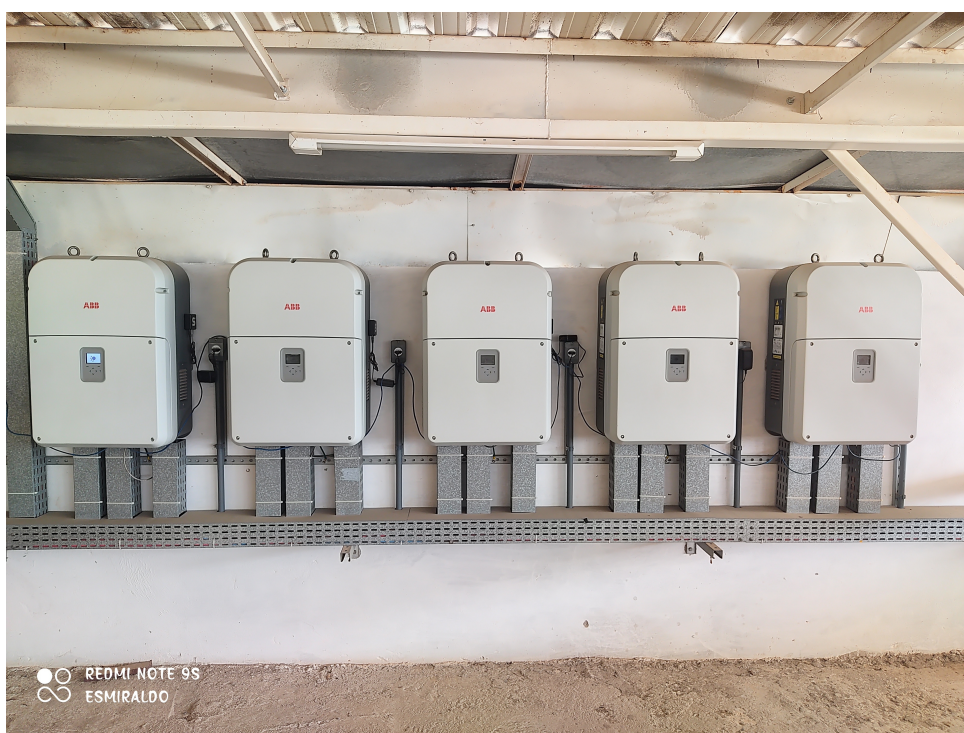
Figura 2.5 – Inversores ABB do Sistema Fotovoltaico do Campus das Auroras UNILAB-CE
