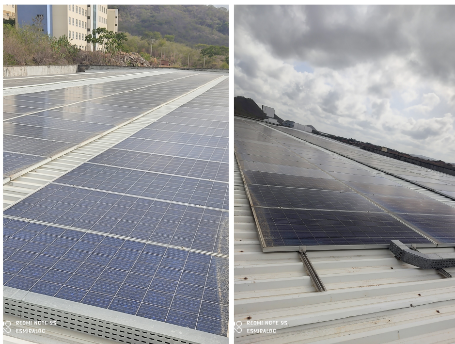
Figura 2.4 – Módulos solares fotovoltaicos instalados no Campus das Auroras
