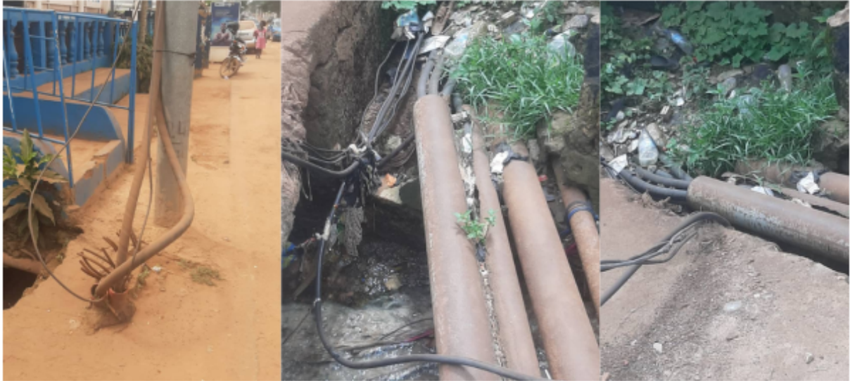
Figura 7 – Infraestruturas e materiais obsoletos nas ruas de Bissau.
