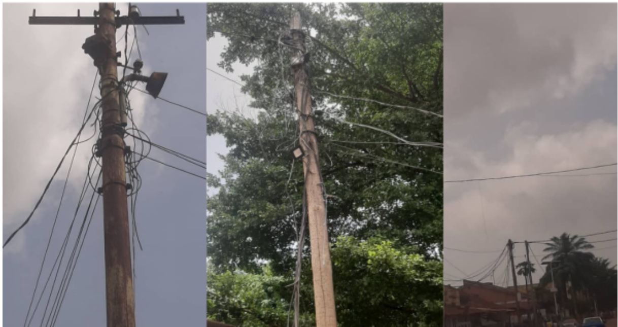
Figura 9 – Infraestruturas e materiais obsoletas nas ruas de Bissau .
