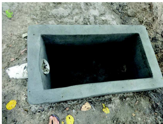
Figura 25 - Caixa de descarga do biodigestor
