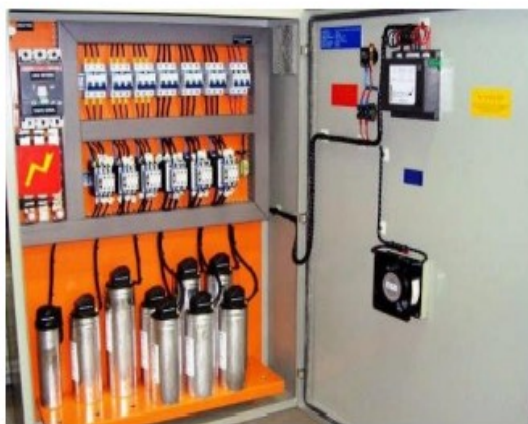
Figura 6: Banco de Capacitor automático
