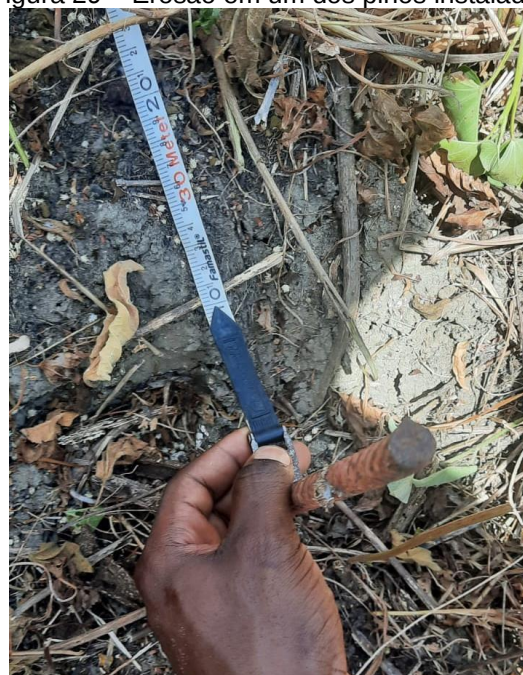
Figura 29 – Erosão em um dos pinos instalados
