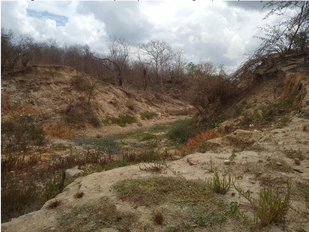
Figura 22 – Detalhe da seção da parede da barragem que colapsou em 2020
