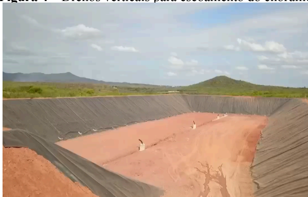
Figura 4 – Drenos verticais para escoamento do chorume.
