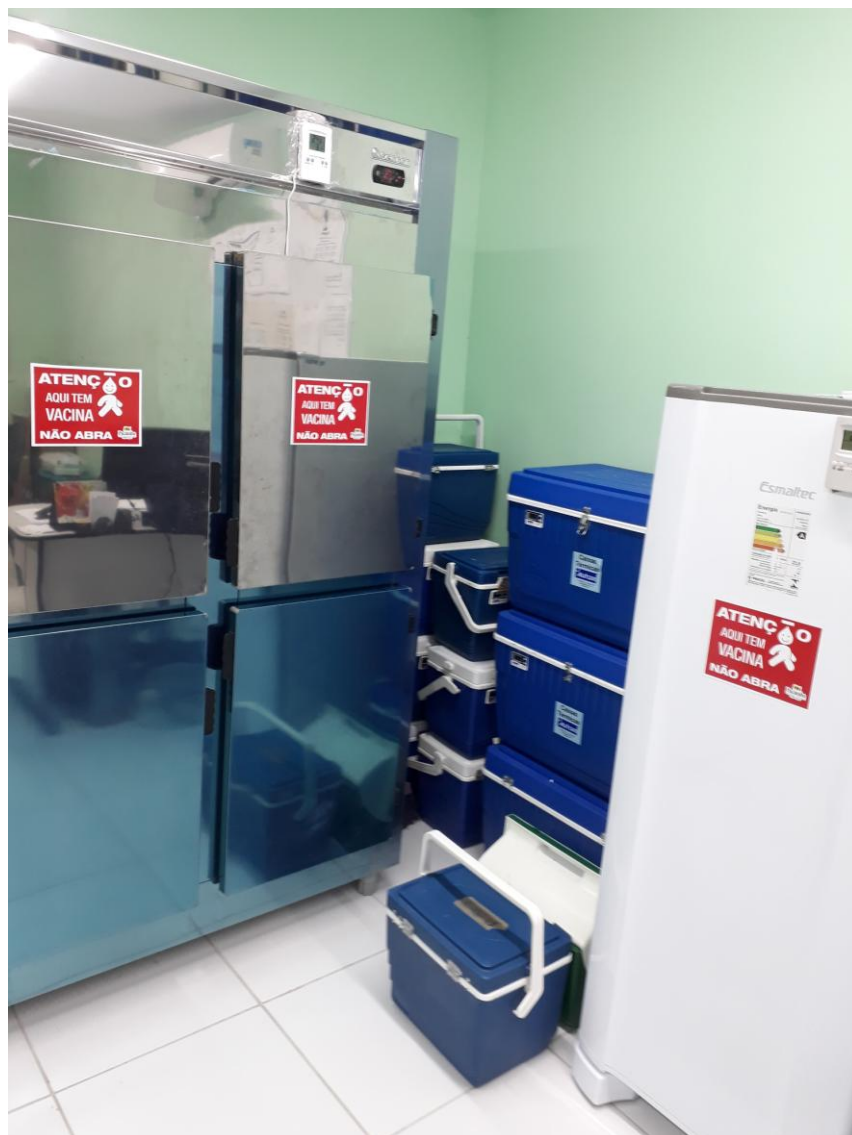
Figura 6: Fotografia do Freezer, dos refrigeradores, e caixas térmicas.
