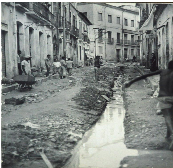
Figura 6 - Rua Gregório de Matos, esgoto a céu aberto
