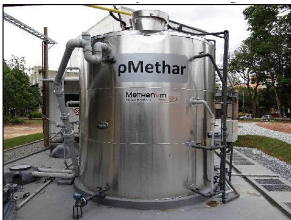
Figura 8 - Reator de metanização de resíduos orgânicos da UFMG
