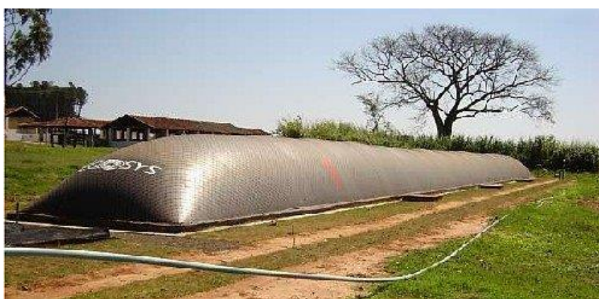
Figura 7 - Biodigestor canadense (balão)
